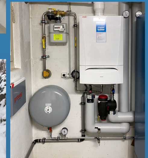
Gasheizung EFH / MFH
