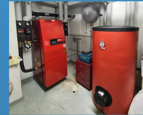
Ölheizung EFH / MFH
